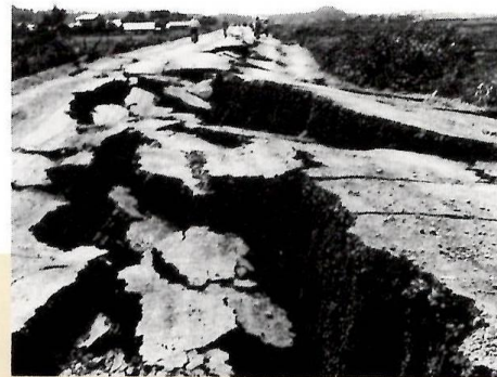
新潟地震 道路地割れ (昭和39年6月)
