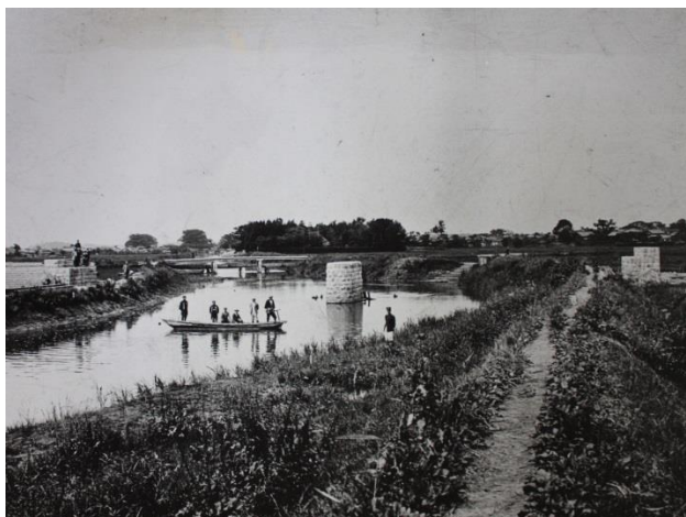
新井田川 酒田駅南方の新井田川にて架橋工事をしている。
