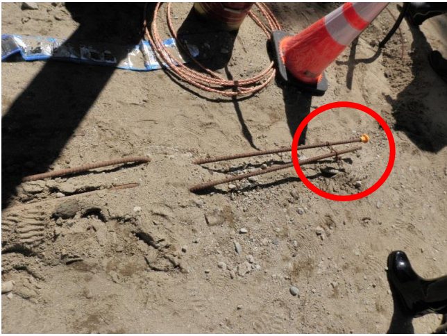
× 鉄筋の養生と明示が不十分 鉄筋の養生と明示が不十分で躓きやすい箇所があった。
