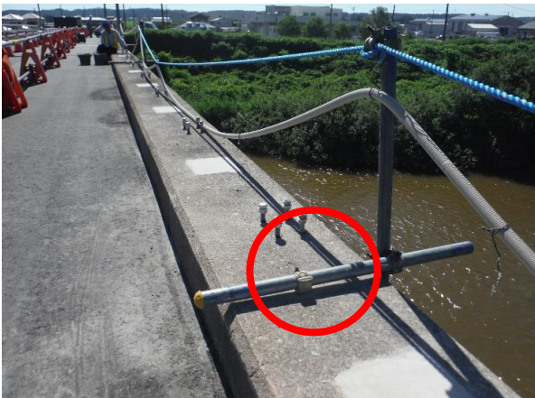
× 転落防護柵のぐらつき 防護柵を固定しているクランプが1箇所であるためぐらつきが生じている。
