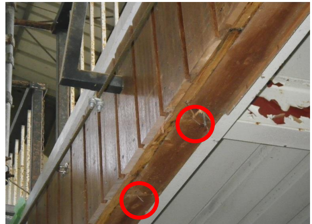
×撤去後に釘が残されている 間仕切撤去後、釘が残されていて危険である。
