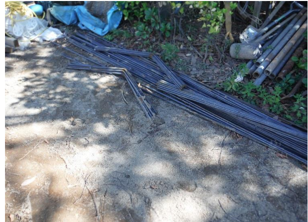
×鉄筋が地面に直置き 鉄筋が頭部が地面に直置きされており、台等に載せておくべきである。
