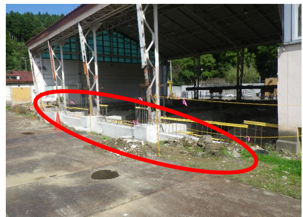
×危険防止のバリケード未設置 工事現場に注意テープは張ってあるものの、危険防止のバリケードを設置すべきである。
