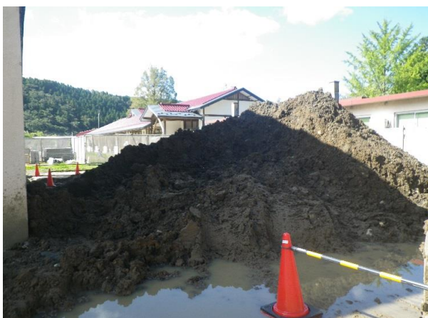
×土砂が建物に近く、未整形 現場内に積み上げられた土砂が、建物に近く、整形されていないために危険である。
