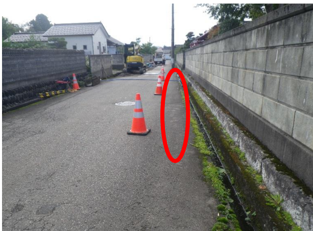
×歩行者用通路の安全確保が不十分 セーフティコーンで確保された通路が狭く、片側が蓋のない水路になっているため、歩行者の安全確保ができていない。
