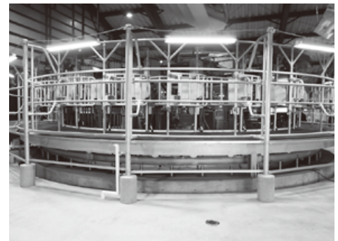
最新鋭の搾乳ロボットが設置されたロータリーパーラー
