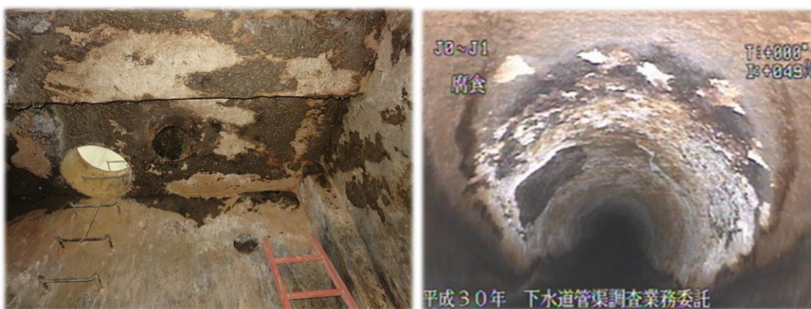
写真2-4 腐食劣化した処理施設（汚泥貯留槽）と管路施設（管きょ内面）
