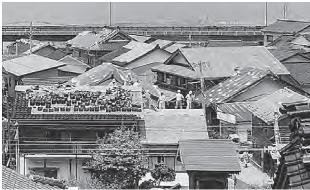
▲山形県沖地震で破損した屋根(鶴岡市温海地区)
