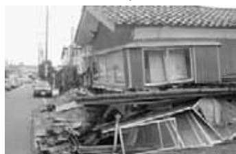
▲新潟県中越沖地震(平成19年)で倒壊した家屋
