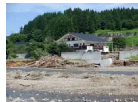
③青沢地区農業集落排水処理施設の擁壁崩落
