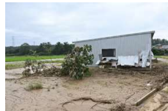
③土砂の流入により破損した車庫
