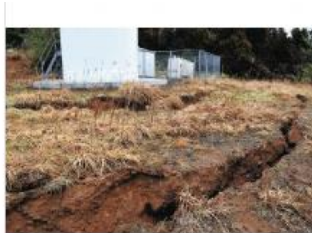
基礎地盤の破壊
