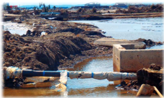
▲地震でも被害のなかった耐震管
