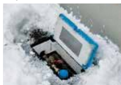
除雪後のメーターボックス
