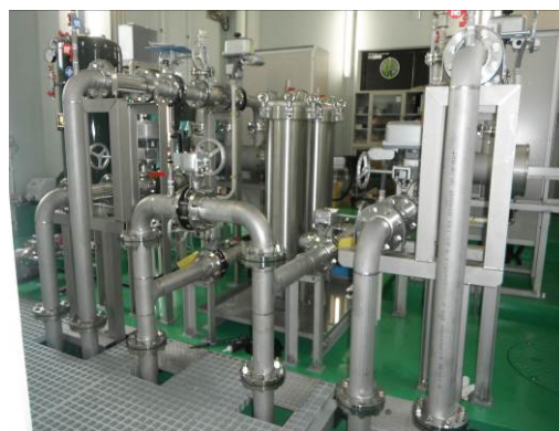
▲ 紫外線照射装置（升田水源地）
