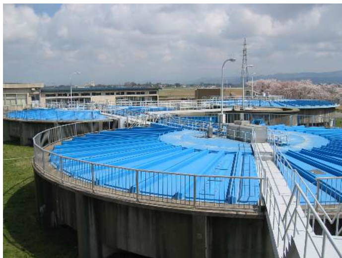
小牧浄水場 高速沈でん池
