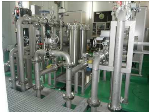
▲ 紫外線照射装置（升田水源地）
