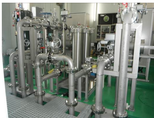
▲ 紫外線照射装置（升田水源地）
