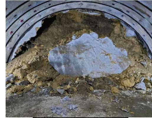
写真②:切羽崩落
