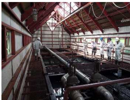
油水分離施設（油水分離槽）
