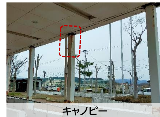
外壁剥落箇所
