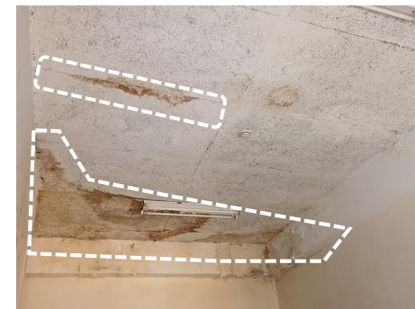
天井の雨漏り(玄関と用具室)
