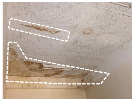
天井の雨漏り(玄関と用具室)
