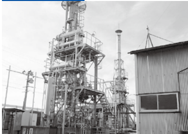
酒田工場(下瀬)左より常圧蒸留塔、加熱炉
