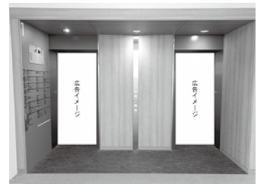
▲本庁舎エレベーター
