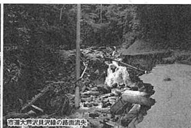
市道大戸沢沢原の路面流失
