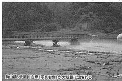
前山橋、荒瀬川左岸(写真右側)が大規模に流される
