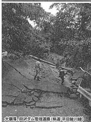
大崩落、田沢ダム管理道路(県道 平田鮎川線)
