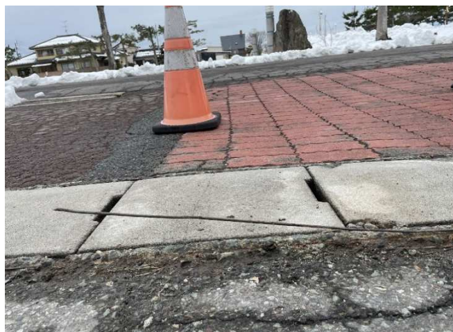
道路側溝 蓋受け部分破損状況 (鉄筋が露出立ち上がり)
