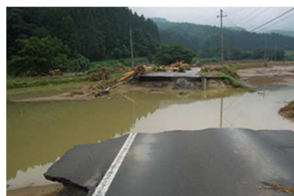
荒瀬川の氾濫による道路崩壊（上青沢地区）
