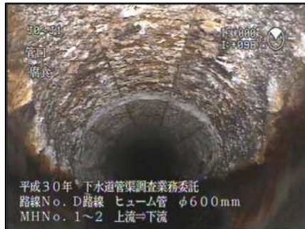
管の腐食状況
