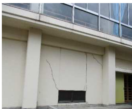
外壁のひび割れ発生
