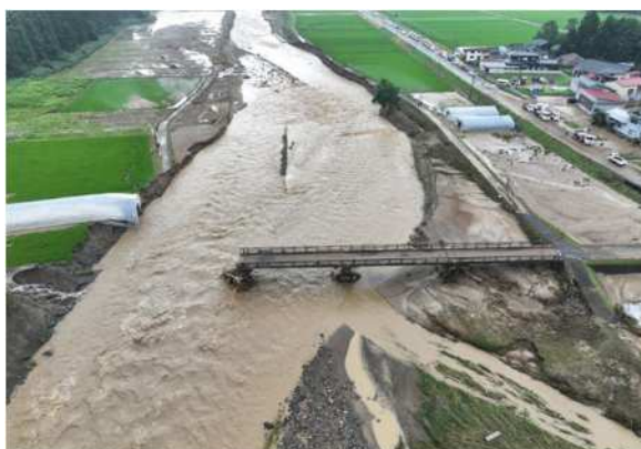
荒瀬川の濁流による橋台背面取付道路流出（前山橋）
