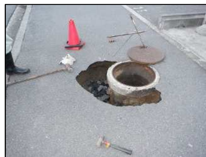
腐食による道路陥没状況
