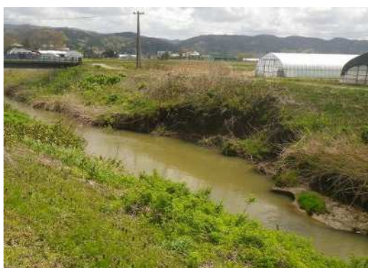
護岸の浸食が進み危険な状態の境川
