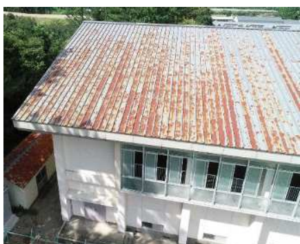
雨漏りの原因となる屋根腐食発生
