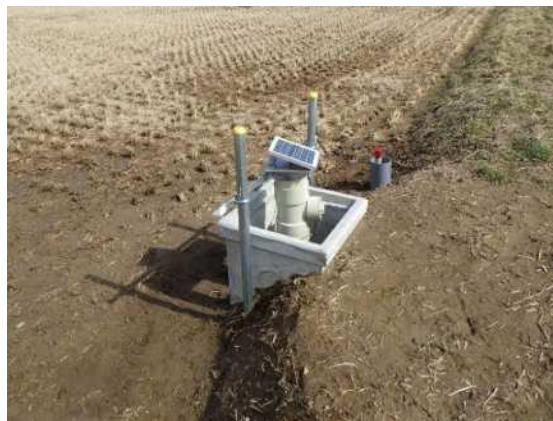
県営土地改良事業で整備された自動給水栓
