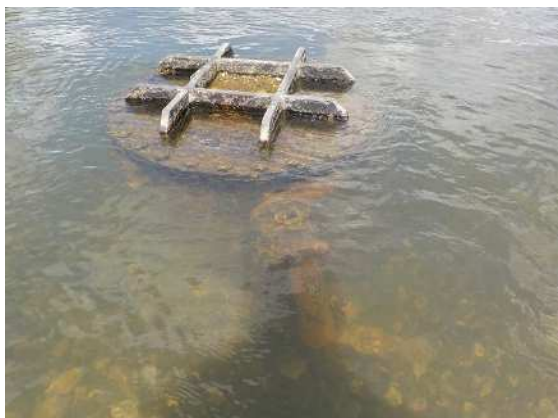
老朽化が進む国営造成施設（サイフォン河床露出）
