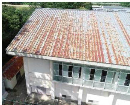
雨漏りの原因となる屋根腐食発生
