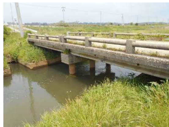
老朽化が進む農道橋梁
