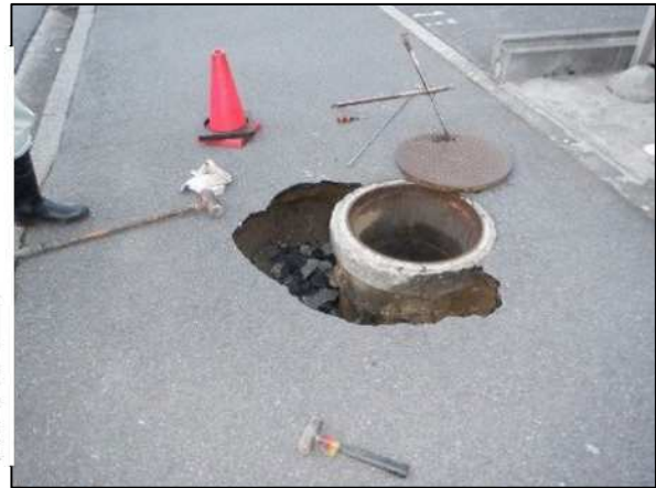
【腐食による道路陥没状況】
