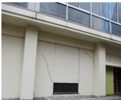
外壁のひび割れ発生
