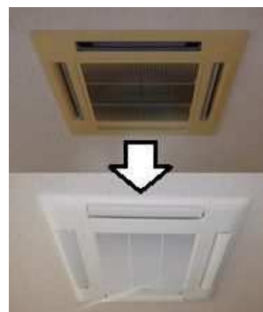
空調設備の更新
