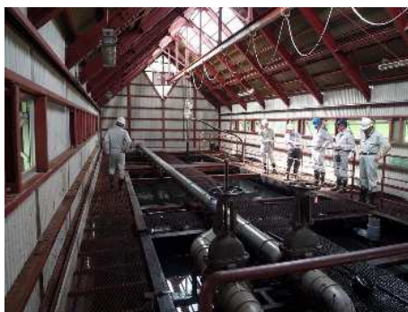
油水分離施設（油水分離槽）
