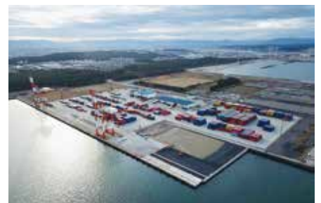
拡張工事が進む酒田港国際ターミナル （写真提供 山形県港湾事務所）
