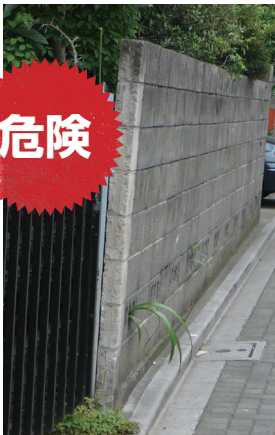
傾いている危ない塀
