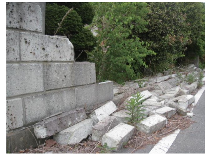
地震により石塀が倒壊
