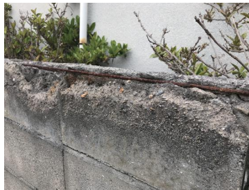
割れや鉄筋の露出がみられる塀
