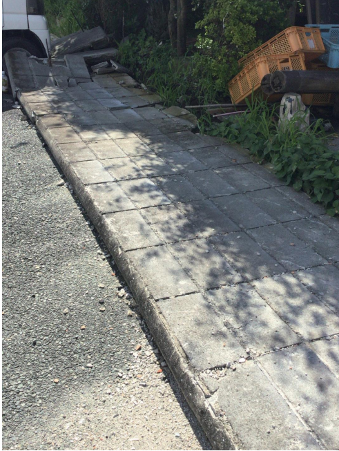
地震によりブロック塀が倒壊
