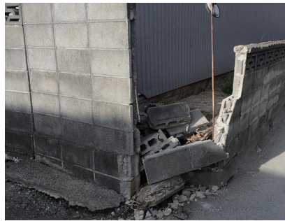
地震によりブロック塀の一部が損壊
