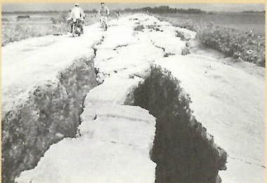
新潟地震・国道47号線(昭和39年6月16日)
