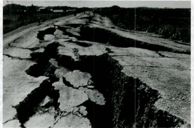
新潟地震による地割れ
