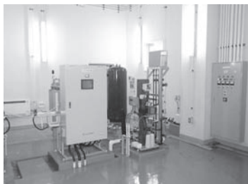
浄水処理設備
