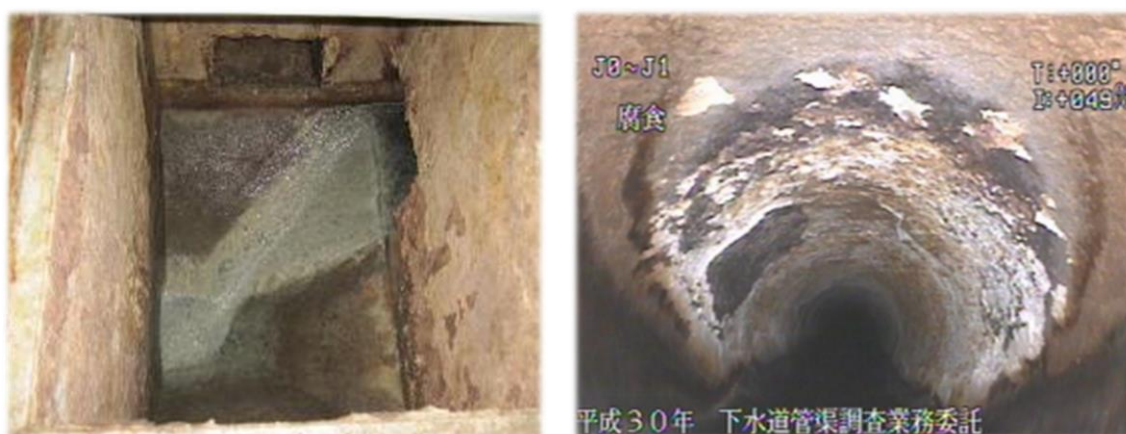
写真2-4 腐食劣化した処理施設（水槽）と管路施設（管きよ内面）
