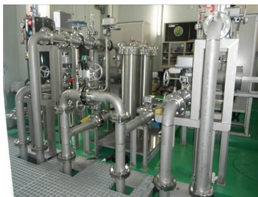
▲ 紫外線照射装置（升田水源地）
