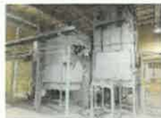
<Li-ion電池リサイクル設備>
