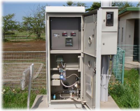
▲監視装置による残留塩素の測定
