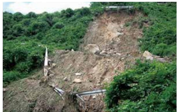
▲平成30年8月 北俣土砂被害の様子
