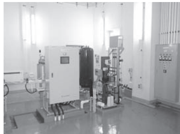
浄水処理設備
