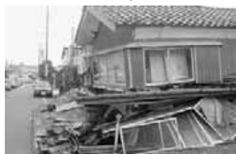
▲新潟県中越沖地震（平成19年）で倒壊した家屋
