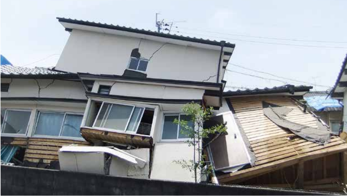
▲地震で倒壊した住宅(熊本県益城町)
