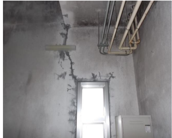
コンクリート壁のひび割れ発生
