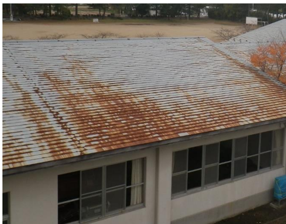
雨漏りの原因となる屋根腐食発生
