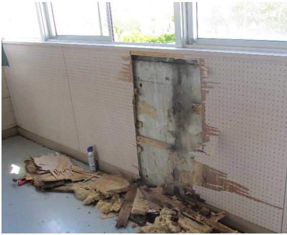
サッシ老朽化により雨漏り、腐食発生
