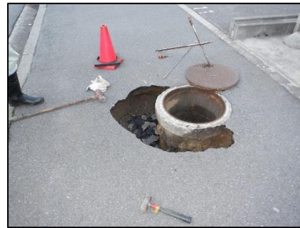
腐食による道路陥没状況
