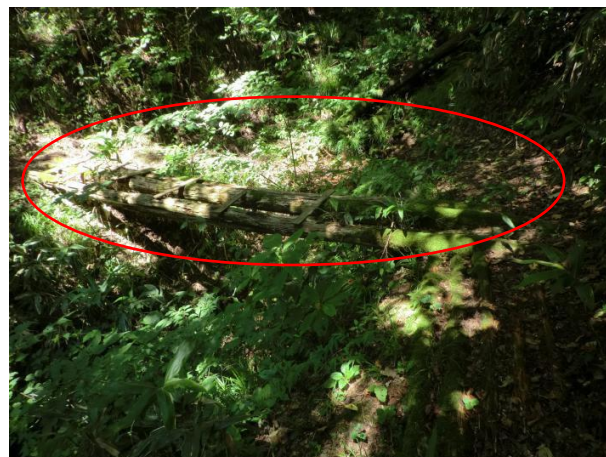
○倒れている遊歩道の架け橋
