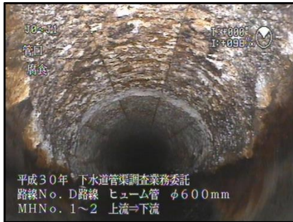
管の腐食状況
