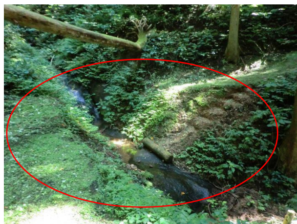
○木道崩落状況
