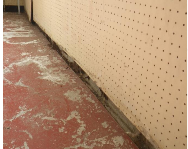
サッシ老朽化により雨漏り、腐食発生
