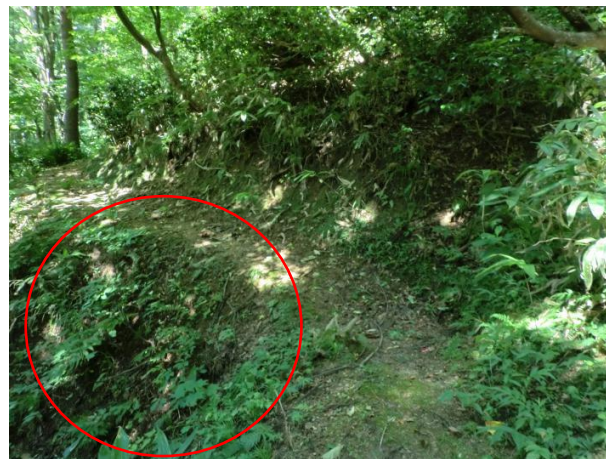
○遊歩道の路肩一部崩落状況
