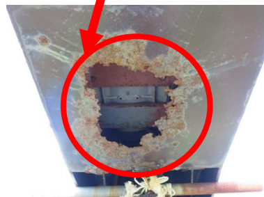
主電動機のカバーが腐食し、雪が吹き込む状態
